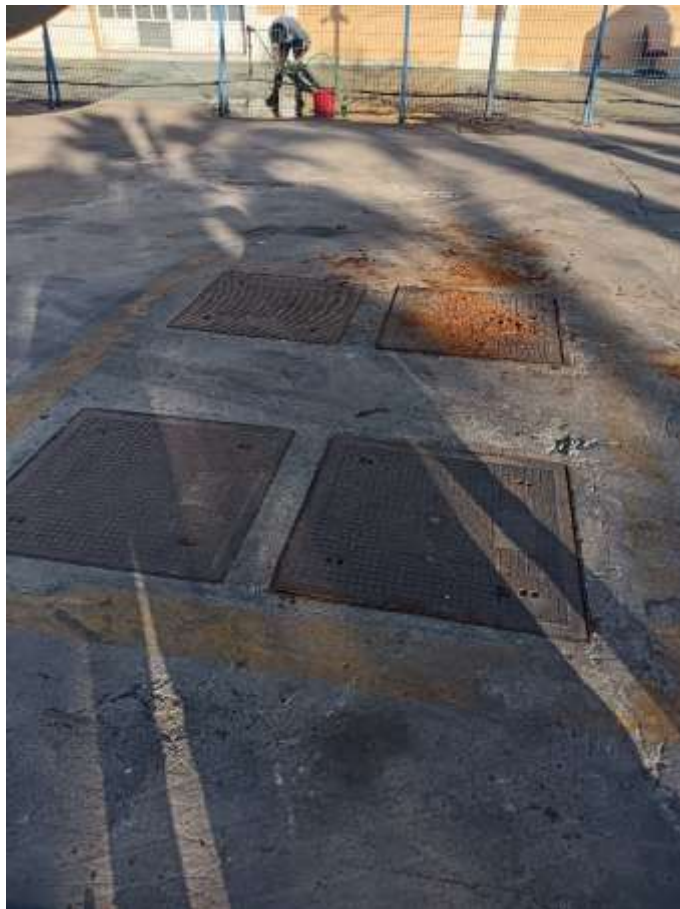
Grupo de bombeo fecales
