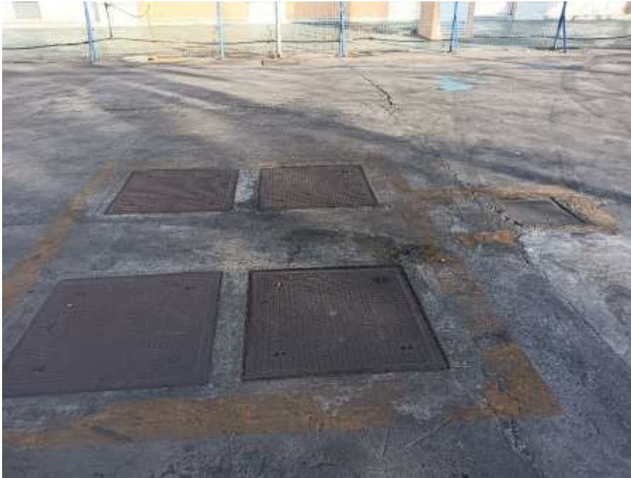
Grupo de bombeo pluviales
