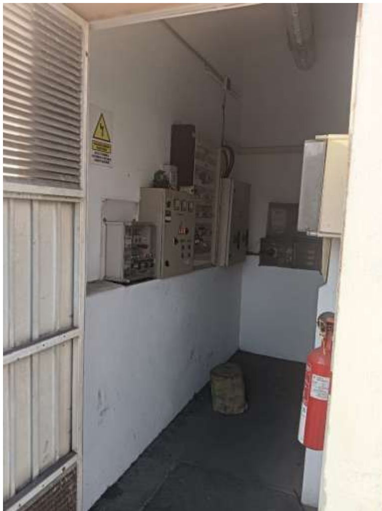
Interior cuarto de instalaciones
